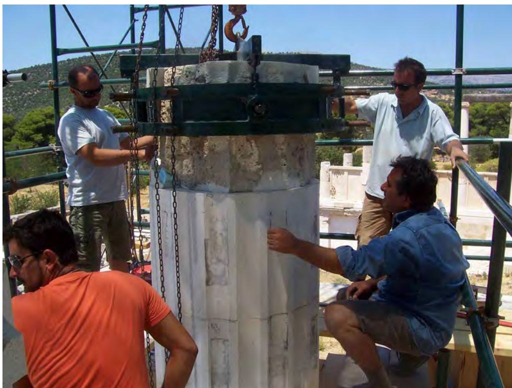
Εικ. 6. Δοκιμαστική τοποθέτηση του 8ου αρχαίου δωρικού σπόνδylου από τους μαρμαροτεχνίτες Θ. Καλαντζή, Χ. Καλαϊτζιδη και τους ειδικευμένους εργατοτεχνίτες Κ. Μάρα, Τ. Θεοδοσίου (φωτ. Γ. Αναστασιάδου).
